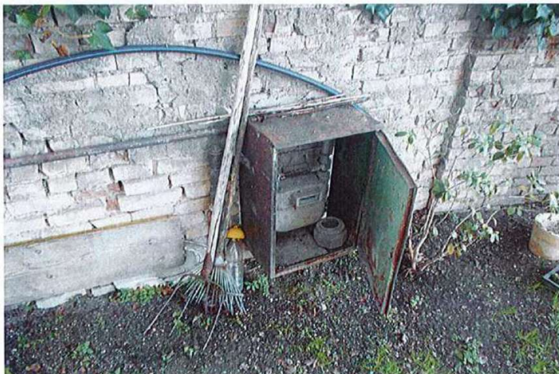
Alloggiamento contatore metano su giardino nord
